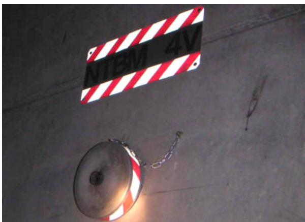
Efter avslutad mätning monteras skyddskåpan åter
